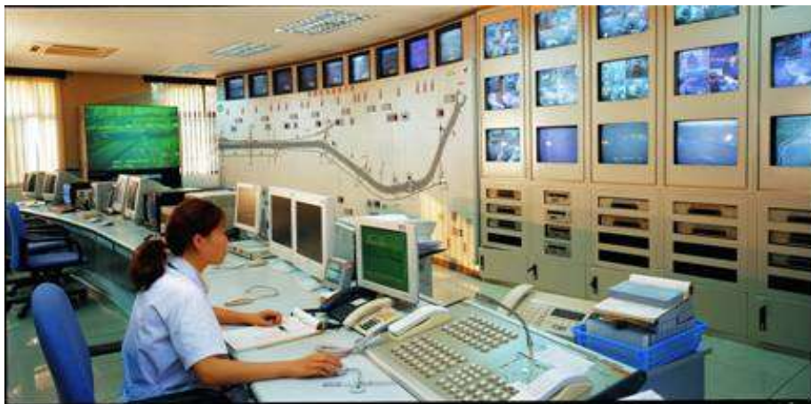
图 7-6 高速公路监控中心
