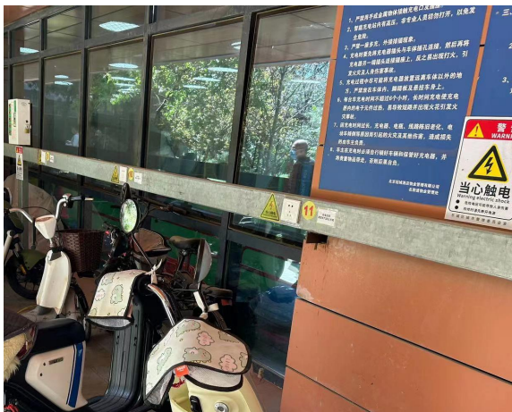
电动自行车充电设施
